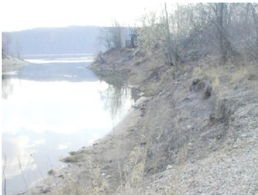
Рис. 3. Размыв дамбы в нижнем бьефе ГЭС
